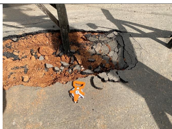
Fragmentos coletados do trecho rompido entre as estacas 10 e 11 da via de acesso ao Povoado Tapera. São Domingos/SE, em 10.06.2022
