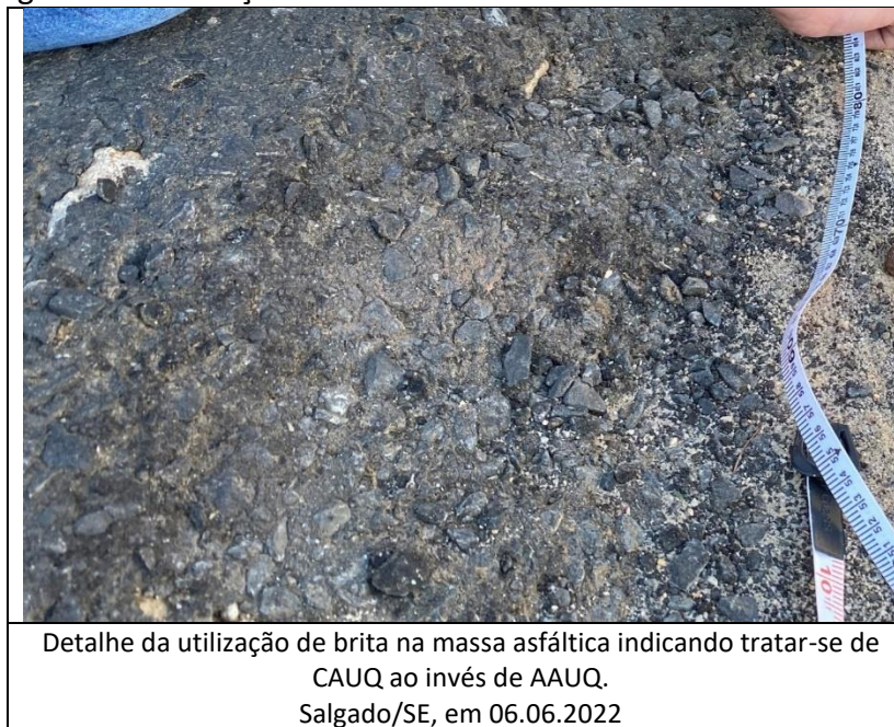
Figura 08: Presença de brita na massa asfáltica utilizada nas obras
