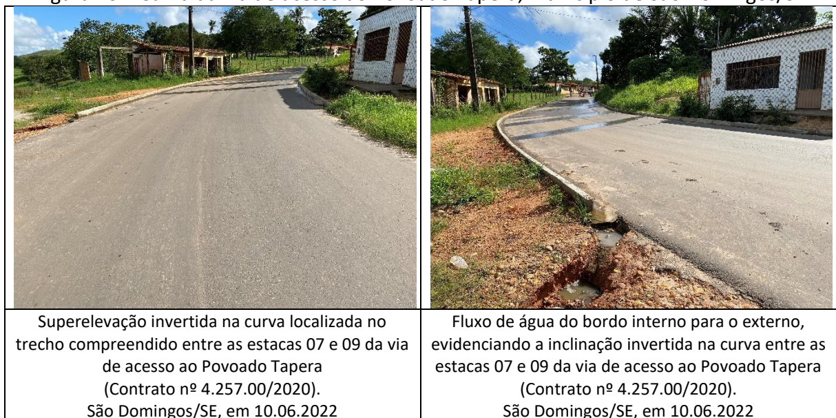
Figura 16 – Curva da via de acesso ao Povoado Tapera, município de São Domingos/SE
