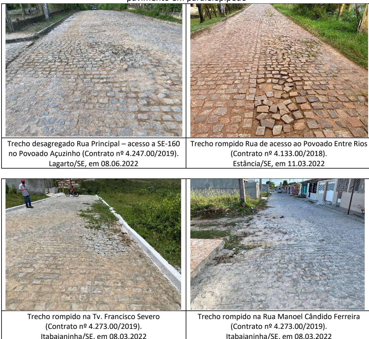
Figura 18 – Registros fotográficos que ilustram algumas ocorrências de desagregação do pavimento em paralelepípedo
