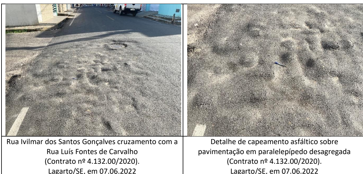
Figura 19 – Registros fotográficos que ilustram algumas ocorrências de problemas na pavimentação
