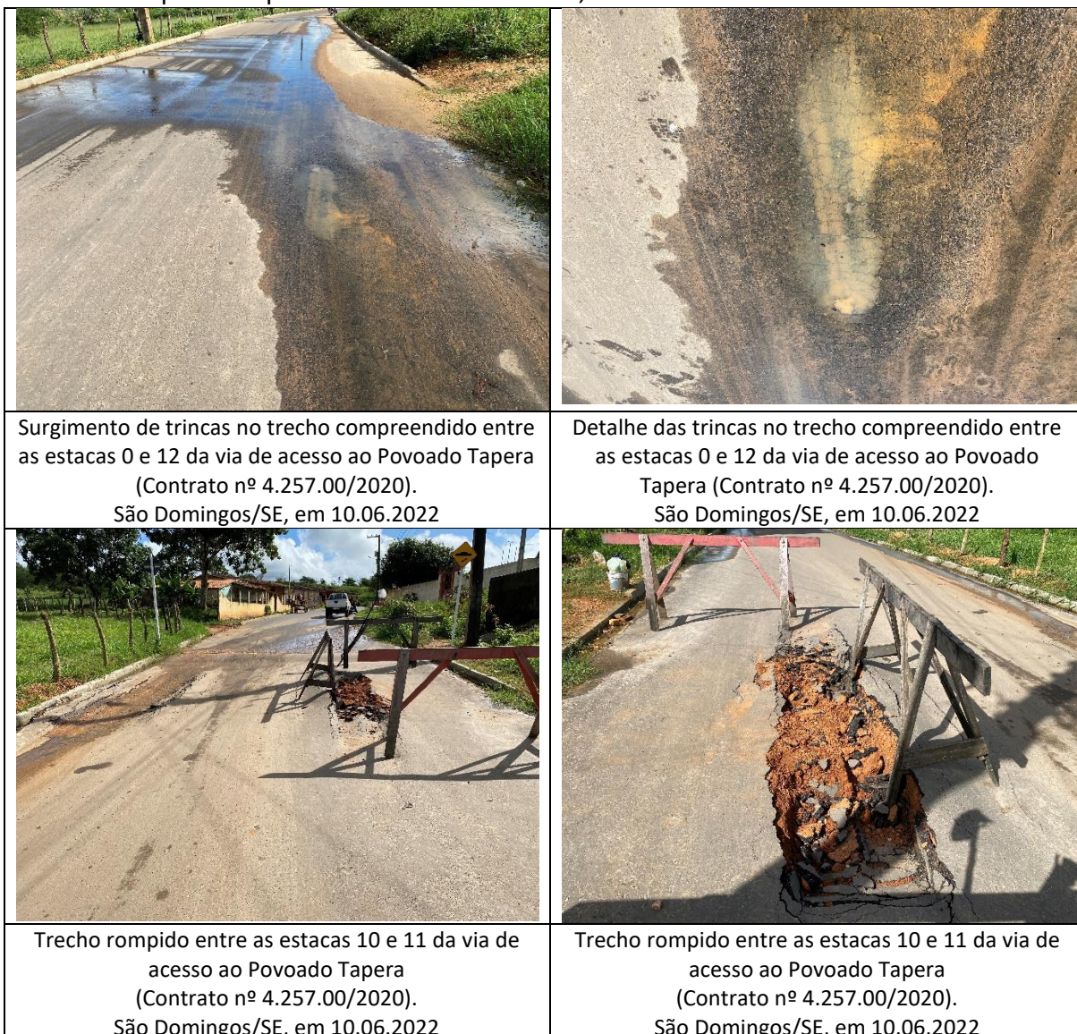
Figura 15 - Via de acesso ao Povoado Tapera, município de São Domingos/SE, com trincas e rompimento parcial da camada asfáltica, com menos de seis meses de uso
