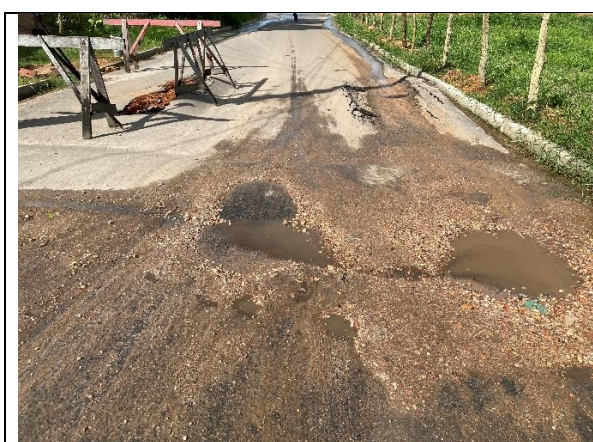
Trecho rompido entre as estacas 10 e 11 da via de acesso ao Povoado Tapera. São Domingos/SE, em 10.06.2022
