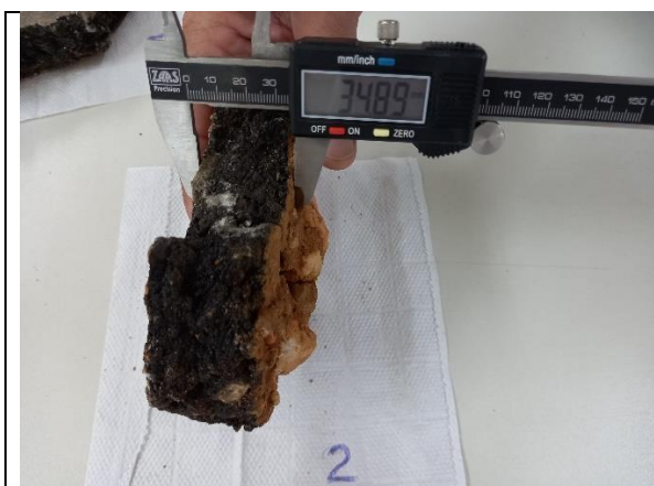
Medida de espessura do pavimento asfáltico na amostra 2 do fragmento do trecho rompido entre as estacas 10 e 11 da via de acesso ao Povoado Tapera. Aracaju/SE, em 15.06.2022
